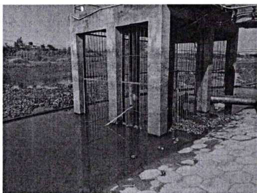
法泗水厂取水泵房（一）
