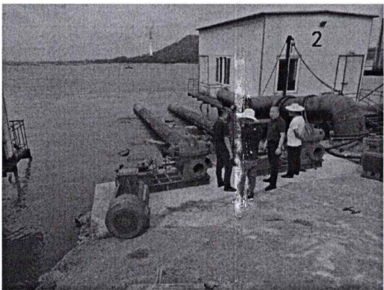
2 号与 3 号缆车之间新增取水泵
